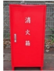
初期消火箱（固定式）
