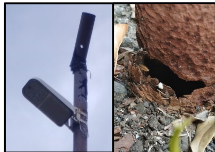
ポールの劣化事例
